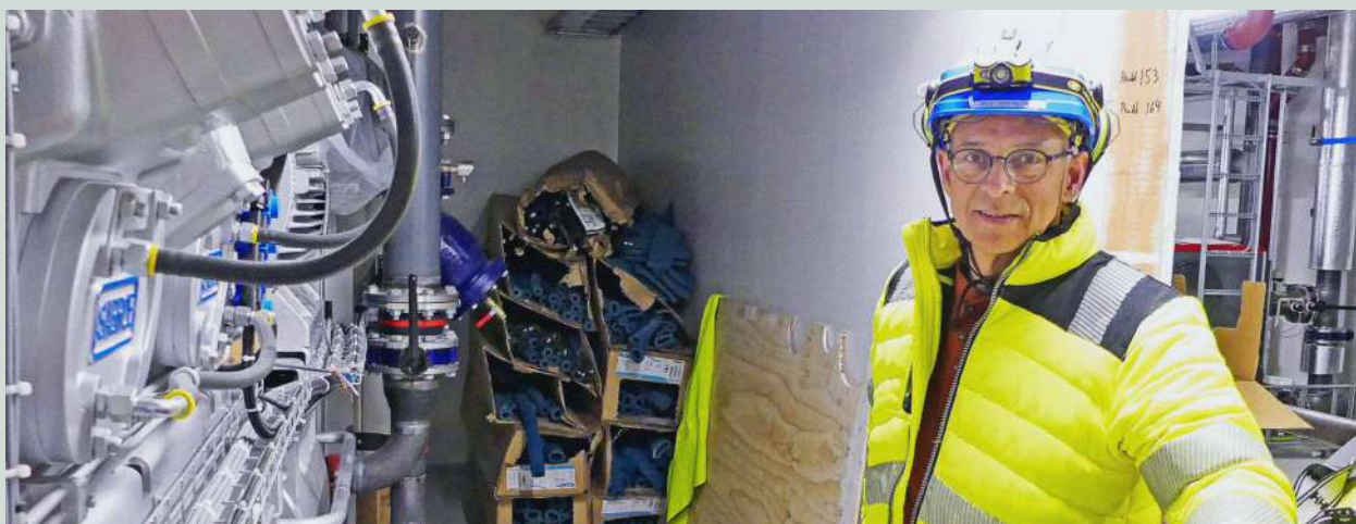
Viggo Søderblom ved siden av det pumpende «hjerne» i det nye sykehuset og helsehuset. Varmepumpa henter opp bergvarme, fra 300 meter ned i fjellet under sykehuset.
