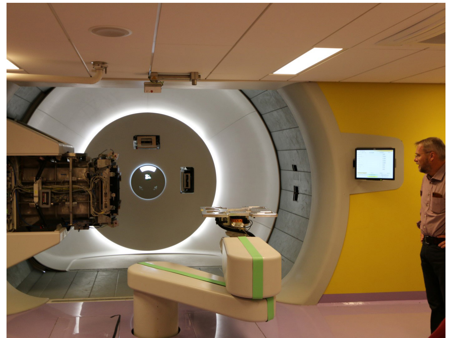
Eksempel på montering av Gantry pasientside.
